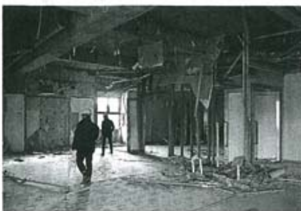
はがれ落ちた屋根などが散乱したままの会館内部
