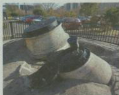
液状化で飛び出したマンホール。周囲に埋まるなどして保存された。(千葉県浦安市の高瀬中央公園で)
